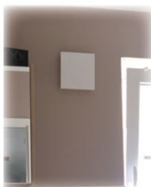
Innenblende im Sanitärbereich
